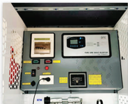
แผงควบคุมไฟฟ้าหลัก พร้อม ระบบกันช็อต กันดูด และสายดิน
