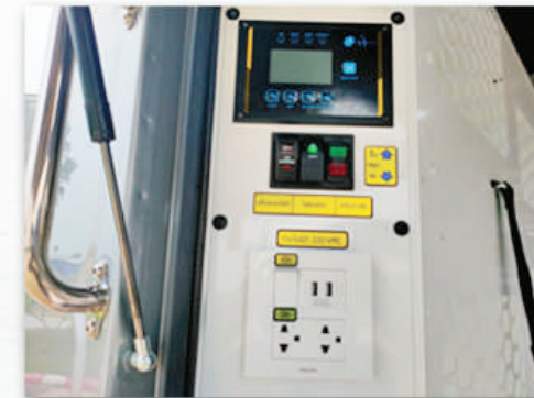
แผงควบคุมการทำงาน ประกอบด้วย Inverter Remote Control panel สวิตช์ต่างๆ เตารับปลั๊กไฟ และจุดจ่ายลม
