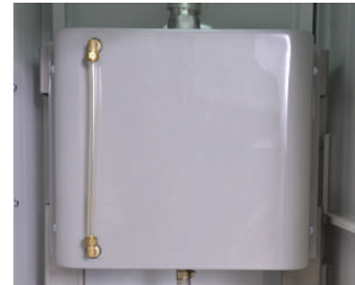
ถังเก็บน้ำมัน
